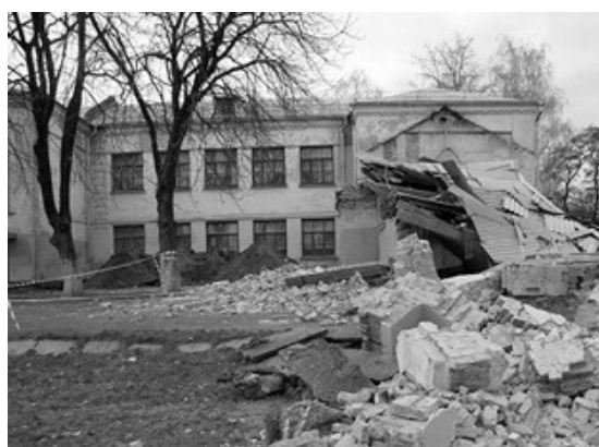
Рис. 5. Часткове обрушення будівлі колегіуму № 11, м. Чернігів
