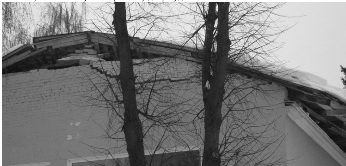
Рис. 3. Обрушення даху дитячого будинку, м. Чернігів
